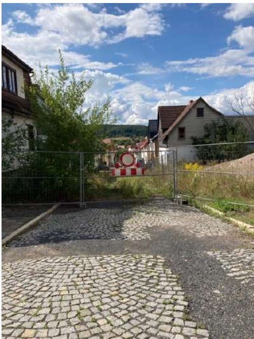
Foto 44: Zustand und Sperrung der Frankensteinstraße seit dem Erdfall 2002
